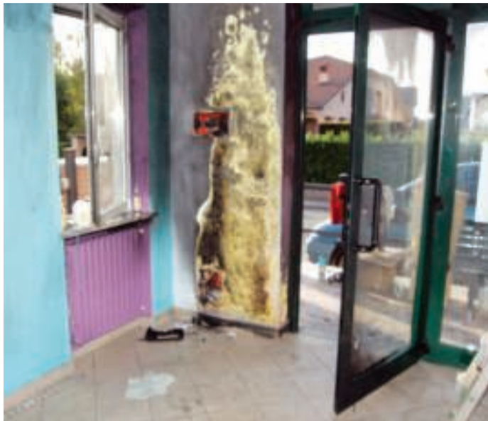
L'INTERNO DEL NEGOZIO annerito dopo l'incendio
